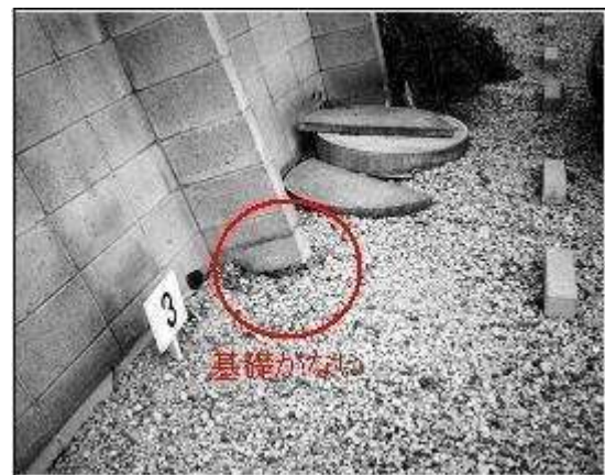
写真5 地震で倒れかかっている塀の被害例
